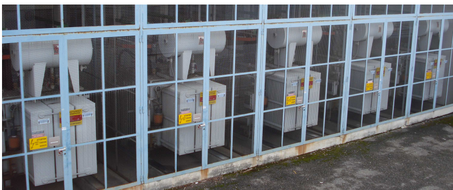
Obrázek 2.1: Transformátorová stanice v ženevském CERNu.
